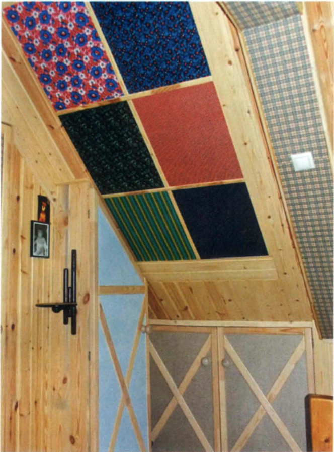
Тканевыми панно декорированы наклонные плоскости, дверки встроенной кладовки между скатом крыши и стеной, небольшого платяного шкафчика и нижние поверхности коробов.
